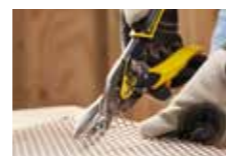
Malla de acero
